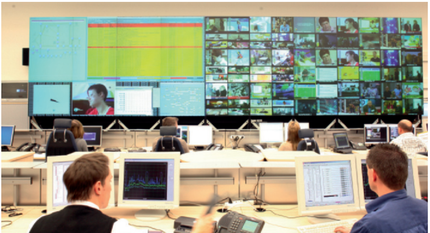
Unitymedia betreibt das am weitesten integrierte Kabelnetz Deutschlands. Das Bild zeigt einen Ausschnitt aus dem Netzbetrieb.
